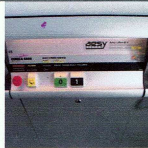
Bedieningselementen in een liftkooi van een platformlift
